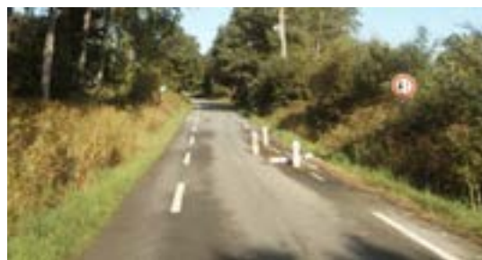
HORS AGGLOMERATION - Obstacle sur bande latérale à cause du mobilier renversé (Dourgel, Pleuven)
