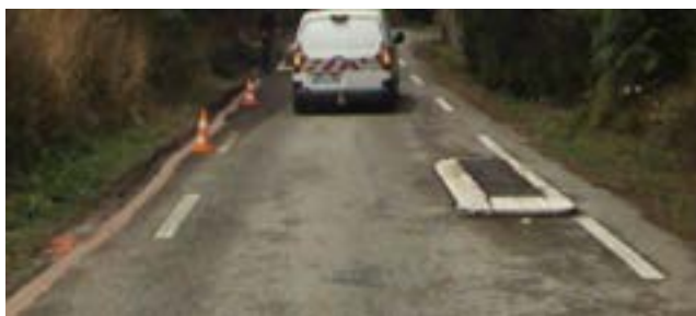
HORS AGGLOMERATION - L'équipement est démunie de balise pour le signaler et les bandes latérales sont recouvertes de végétation, ce qui les rétrécit considérablement (Lanjulien, La Forêt-Fouesnant)
